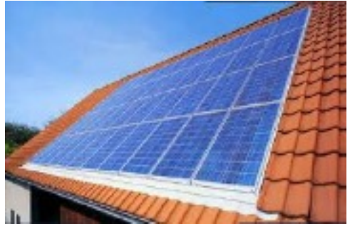
les panneaux photovoltaïques produisent de l'électricité grâce au soleil
